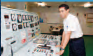
船内のコントロールルーム
