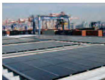
コンテナターミナルに設置された 太陽光発電パネル
